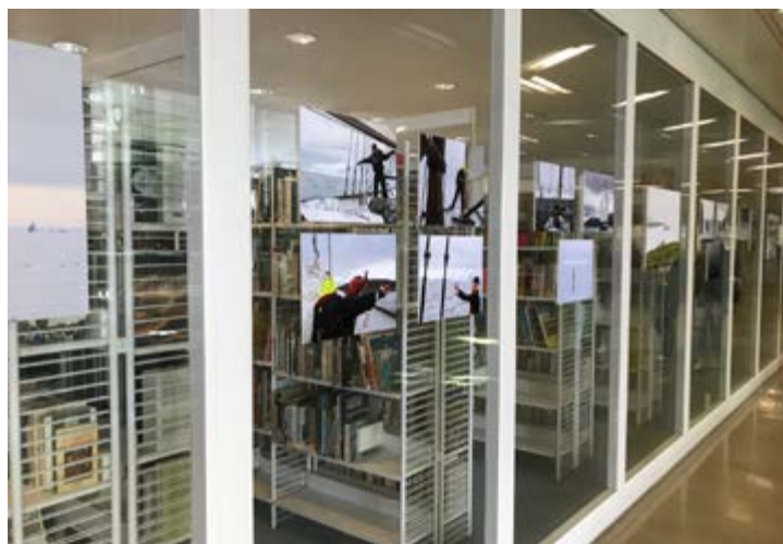
Installation à la médiathèque du CEC André-Chavanne,, mars 2022
